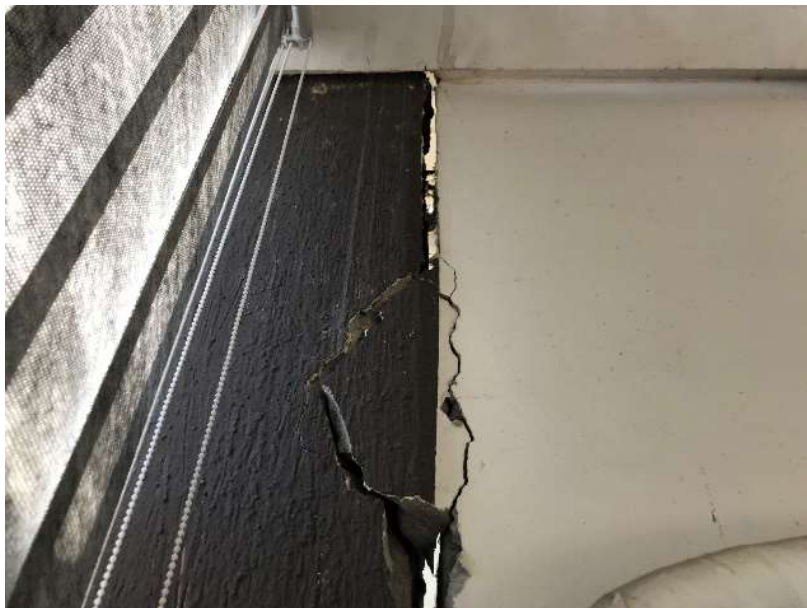
Foto 36 - Ruptura de pilar engastado a parede
