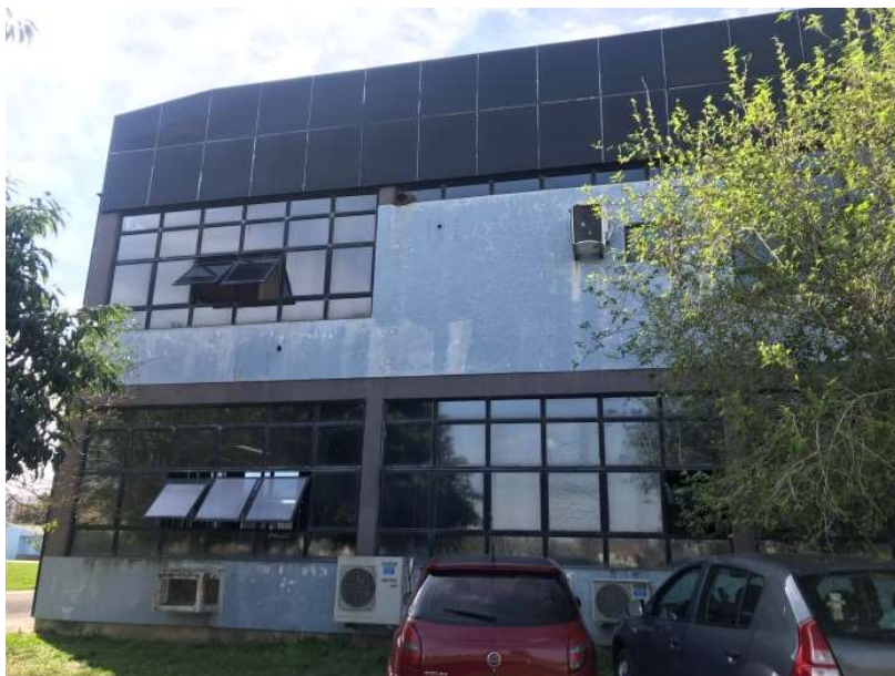
Foto 51 - Pintura fachada lateral com forte desgaste
