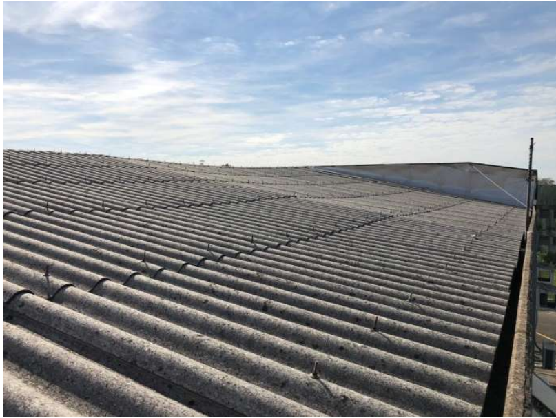
Foto 29 - Vista aproximada do ponto de flexão da cobertura lado oeste
