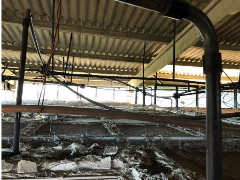
Foto 23 - Vista abaixo do telhado sem contraventamento
