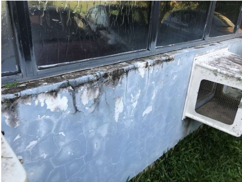
Foto 54 - Manchas de infiltração e ausência de pingadeiras
