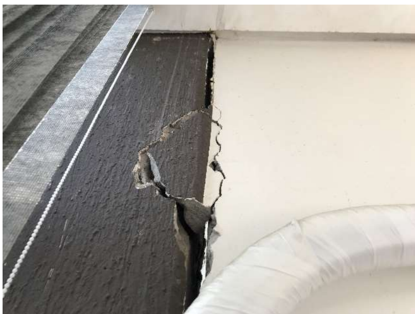
Foto 37 - Ruptura de pilar engastado a parede
