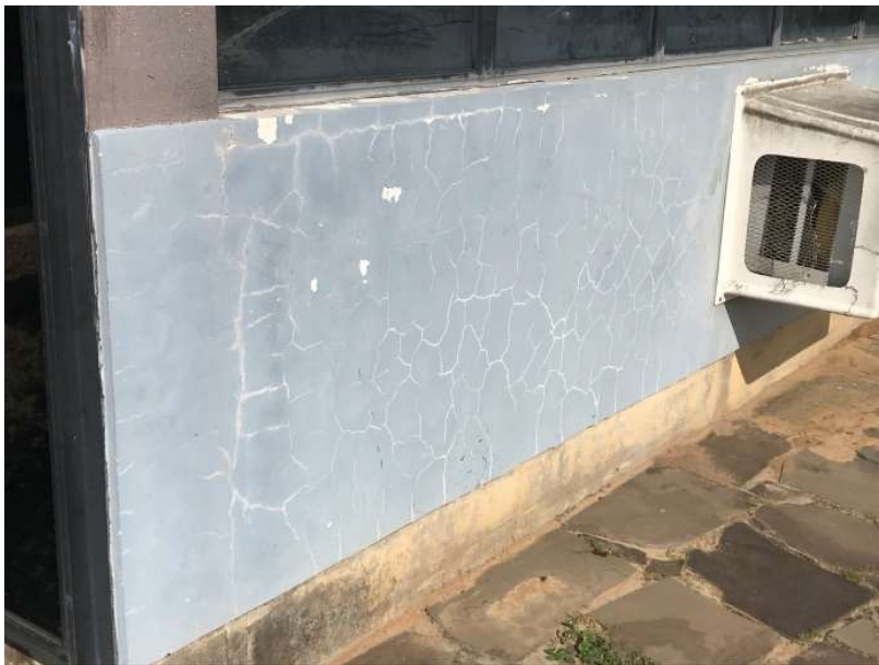
Foto 55 - Pintura com manchas de escoamento pluvial
