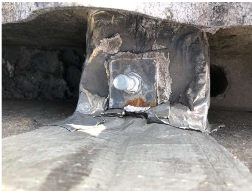
Foto 17 - Vedação de ancoragem degradada
