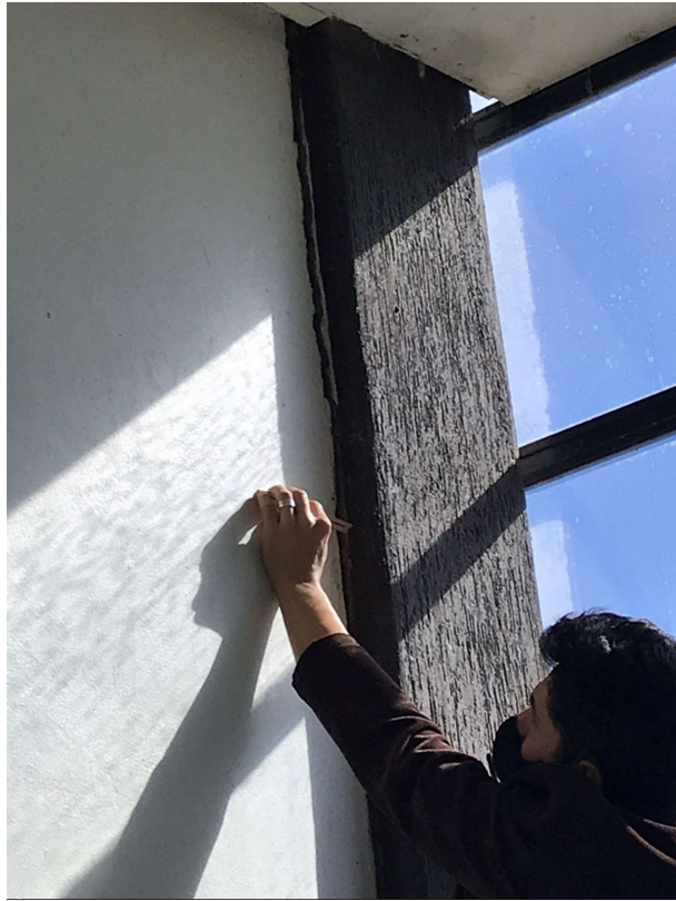
Foto 2 - Rachadura vertical pilar/parede
