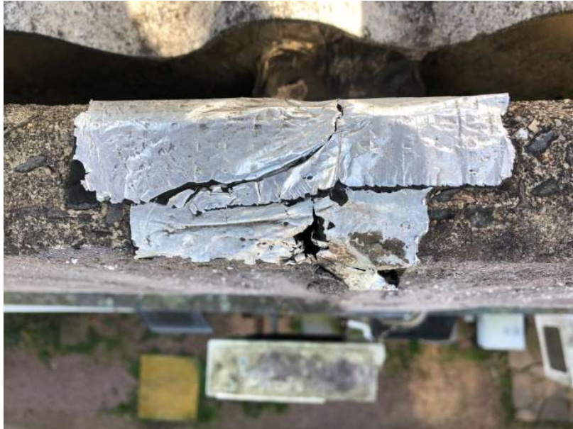
Foto 18 - Vedação de ligação entre vigas danificada
