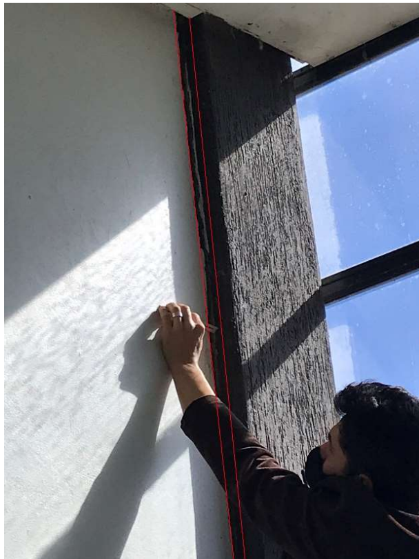
Foto 3 - Rachadura vertical pilar/parede com ilustração
