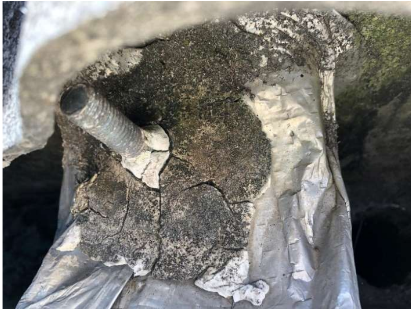
Foto 16 - Vedação de ancoragem trincada
