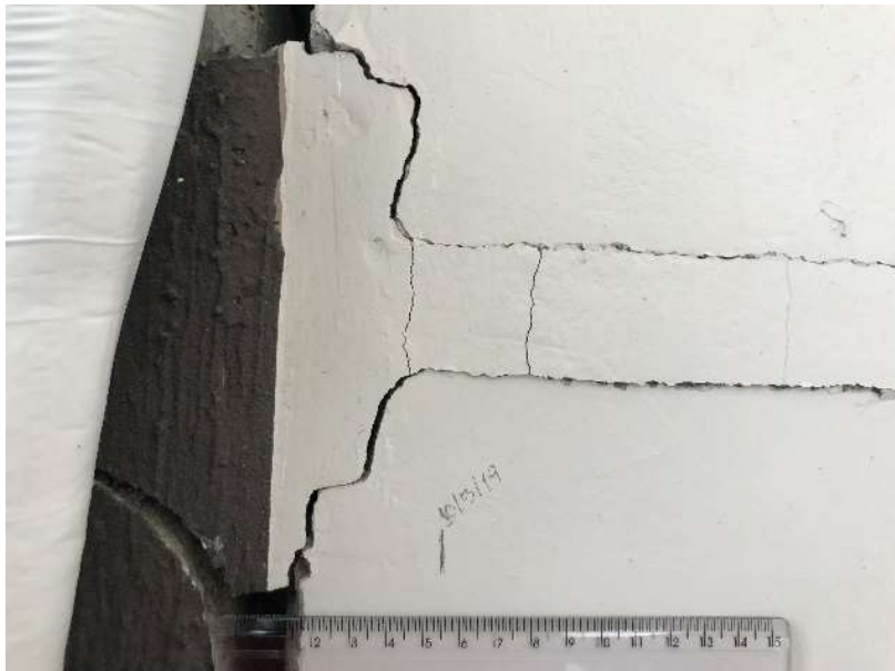
Foto 39 - Ruptura do ponto de conexão entre pilar e parede
