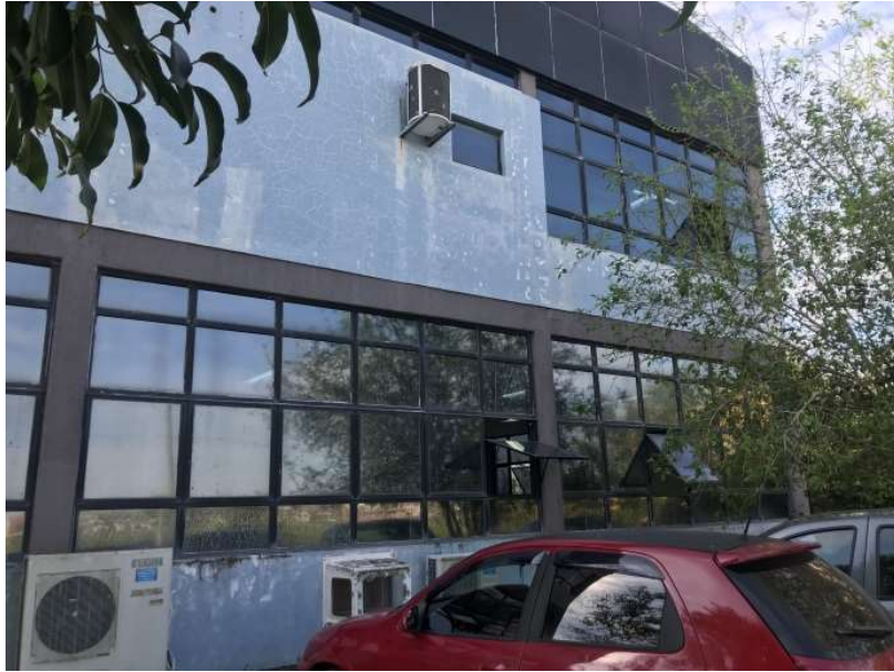
Foto 56 - Revestimento de fachada degradado
