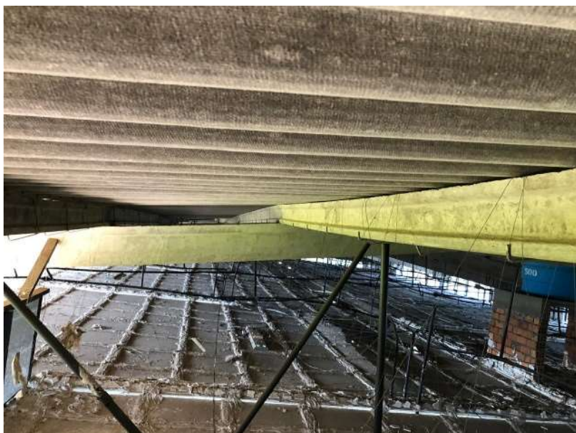
Foto 22 - Inexistência de contraventamento
