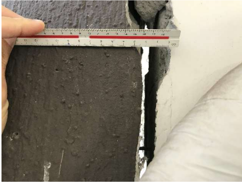
Foto 38 - Medição de abertura entre pilar e parede
