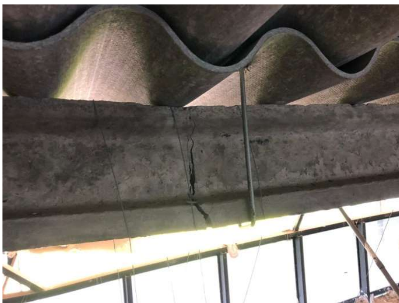
Foto 14 - Rachadura na flexão de viga terça
