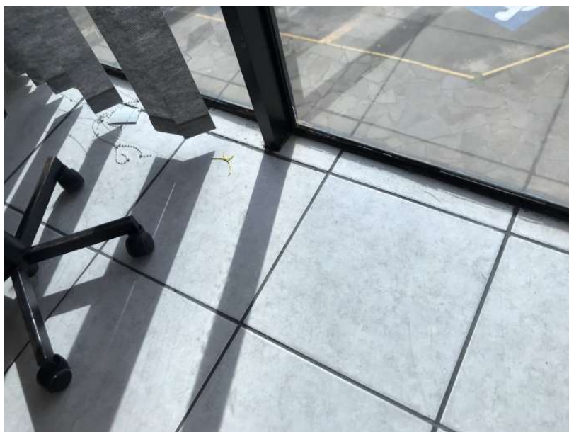
Foto 48 - Piso de pavimentação trincado
