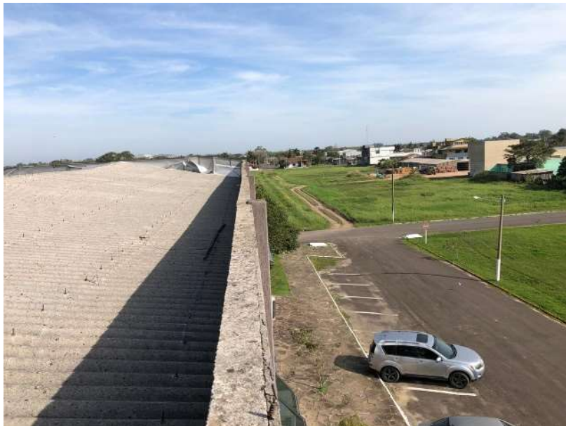
Foto 43 - Vista de perfil da platibanda com desalinhamento
