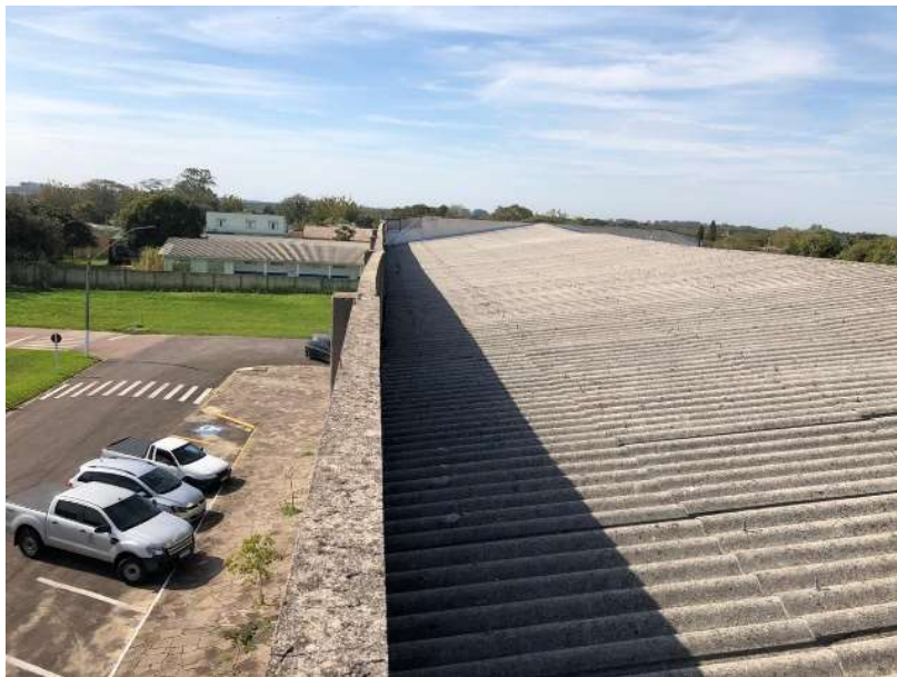
Foto 6 - Desalinhamento de estrutura de fachada frontal
