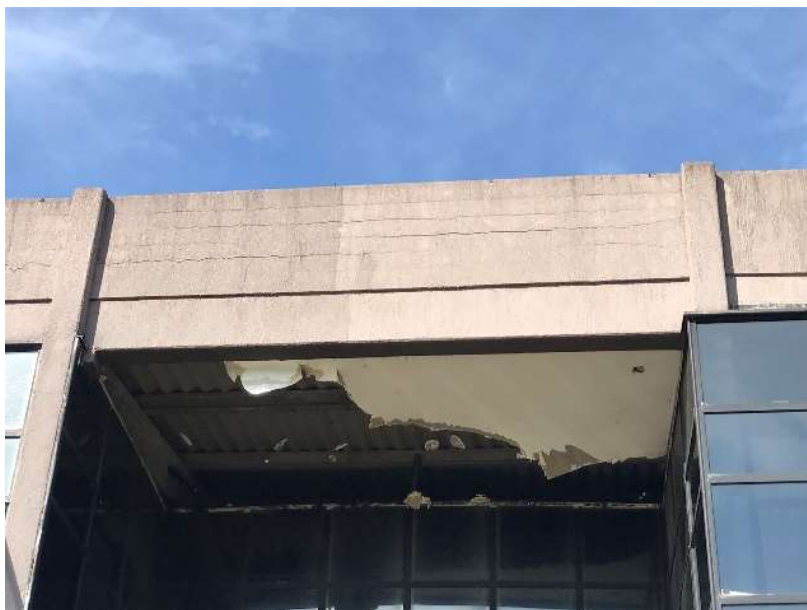
Foto 41 - Vista inferior da platibanda com trincas horizontais
