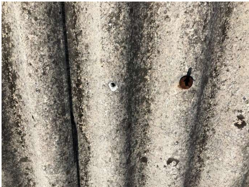
Foto 59 - Ponto de ausência de fixadores do telhado
