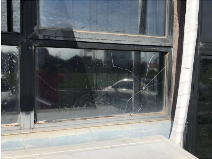
Foto 58 - Vidro quebrado em janela da fachada frontal
