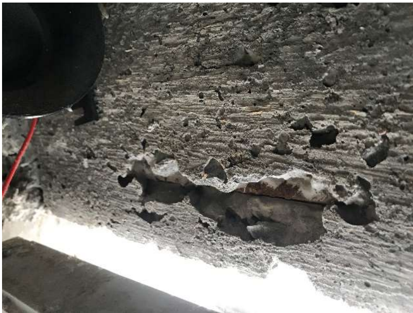
Foto 46 - Nicho de concretagem com armadura exposta
