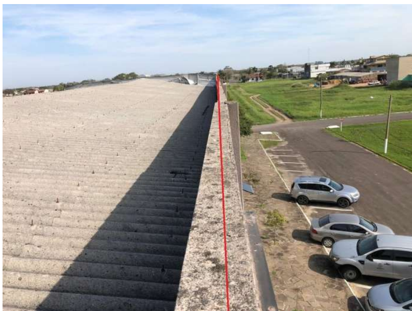
Foto 9 - Desalinhamento de estrutura de fachada frontal vista invertida ilustrado
