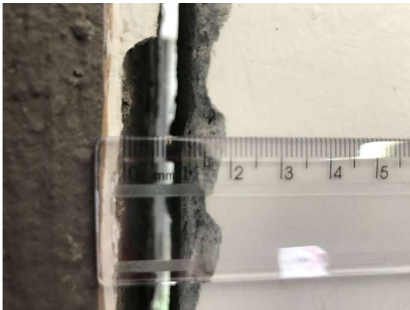
Foto 5 - Medição de espessura de rachadura pilar/parede
