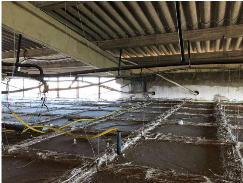
Foto 24 - Ausência de contraventamento
