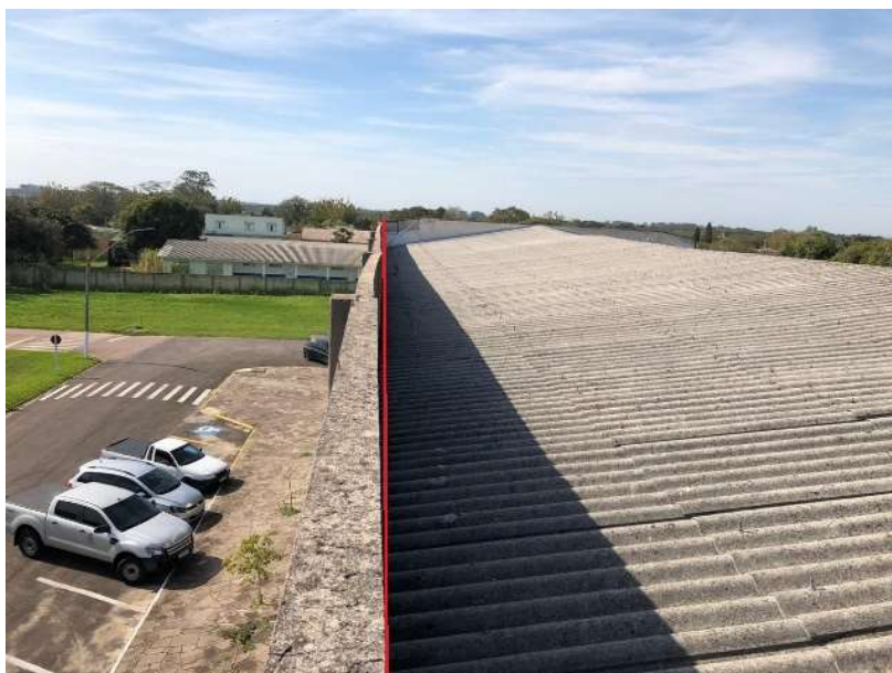
Foto 7 - Desalinhamento de estrutura de fachada frontal ilustrado
