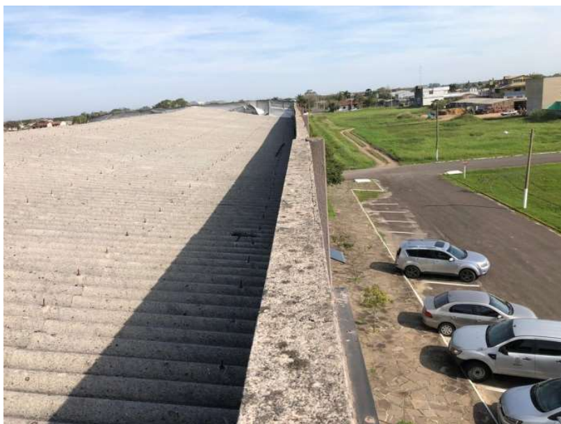
Foto 8 - Desalinhamento de estrutura de fachada frontal vista invertida
