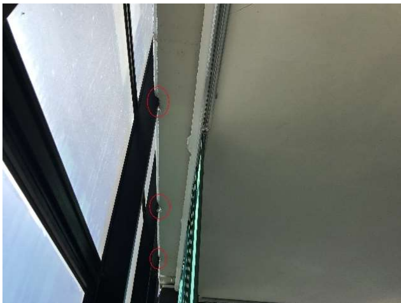
Foto 47 - Pontos de viga com alteração
