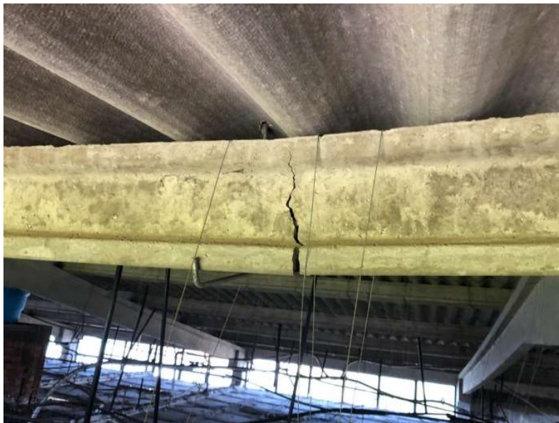
Foto 12 - Rachadura vertical e flexão excessiva de viga terça
