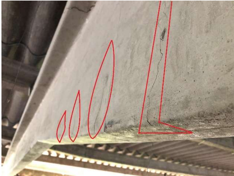
Foto 10 - Trincas e fissuras verticais na viga braço
