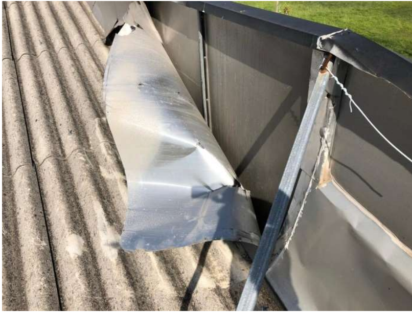
Foto 52 - Rufos de platibanda rompidos
