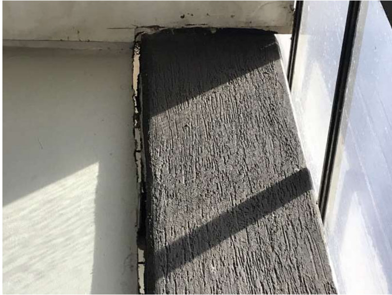
Foto 4 - Rachadura pilar/parede vista aproximada
