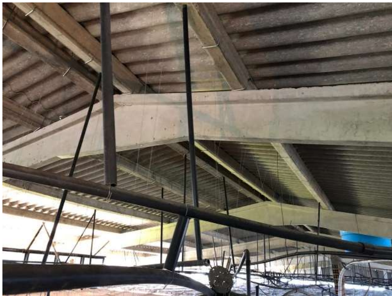
Foto 21 - Vãos sem contraventamento
