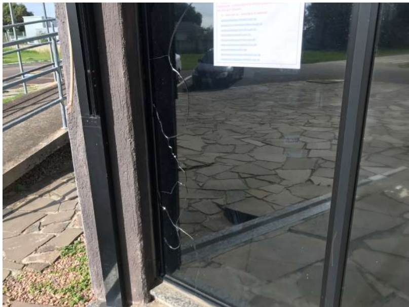
Foto 57 - Vidro quebrado próximo ao acesso principal
