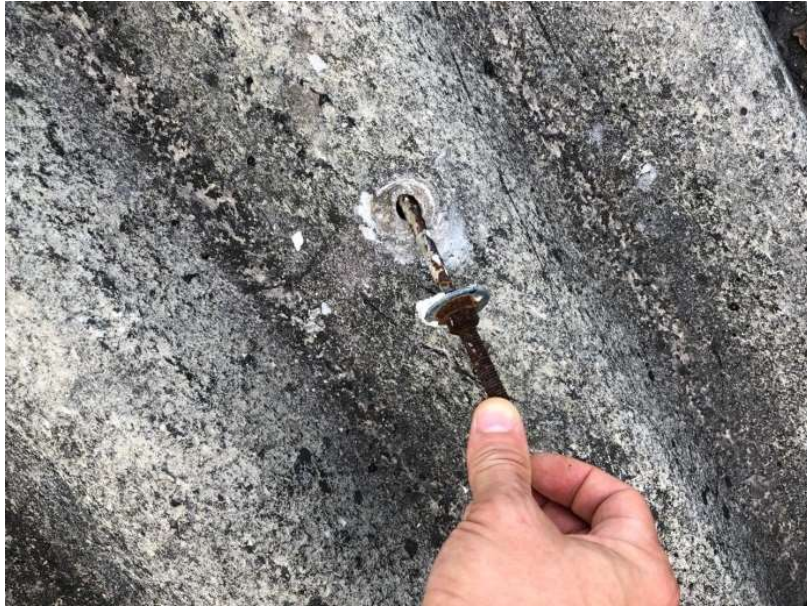
Foto 60 - Corrosão e fragilidade dos fixadores
